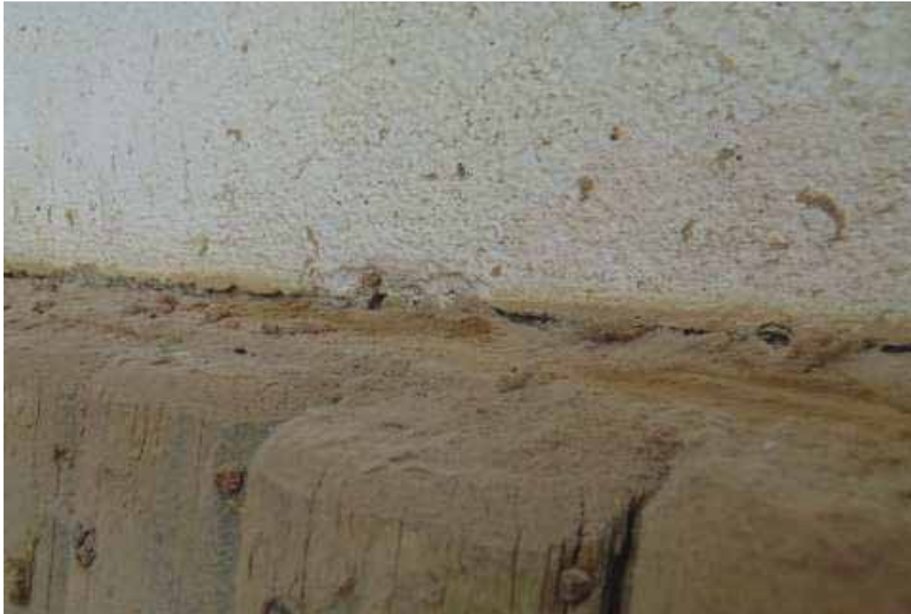
Reithalle Sand und Vlies 1,5 Jahre Schulbetrieb
